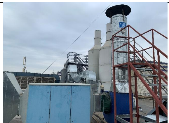
项目废气排放口标识
