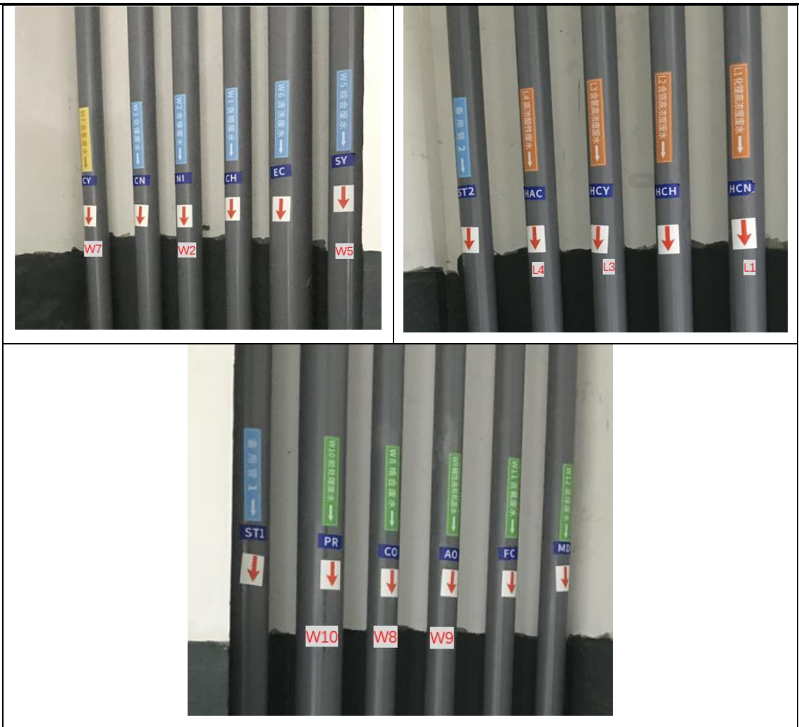
图 4-1 本项目所在 1# 厂房一层废水收集管道
